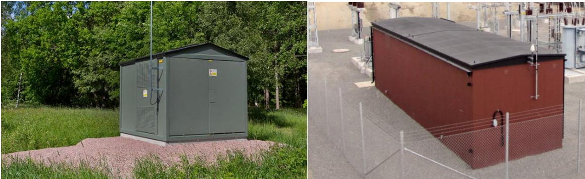
Figur 6. Exempel på transformatorstation (till vänster). Exempel på mottagningsstation (höger).
