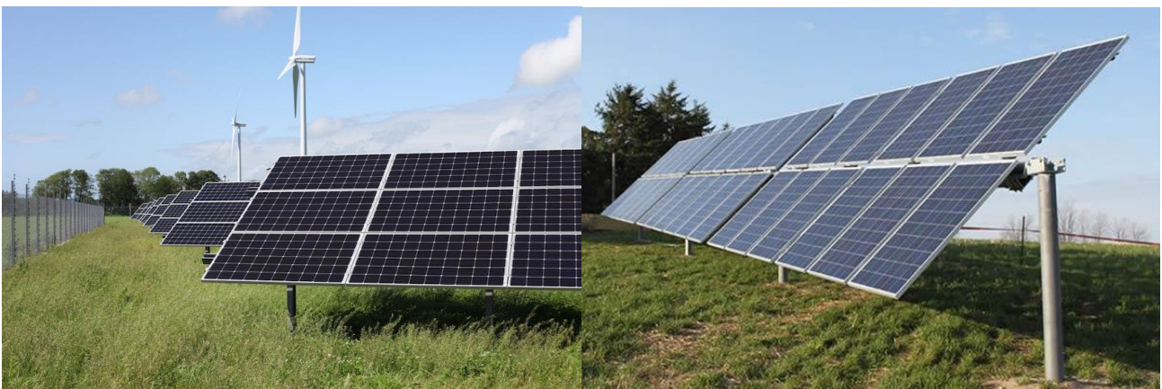
Figur 3. Exempel på kiselsolcellsmoduler med aluminiumram på markställning (vänster). Bilden visar Varberg Energis park Solsidan i Tvååker. Exempel på solcellsmoduler på enaxliga solföljare (höger).
